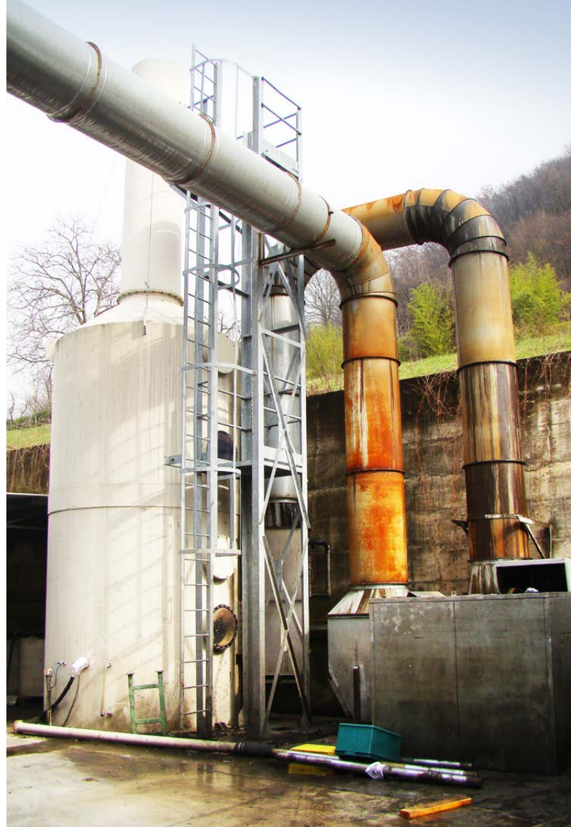
> Gom-fer. Lo scrubber, abbattitore di vecchia generazione destinato ad essere sostituito dalla tecnologia a coalescenza
