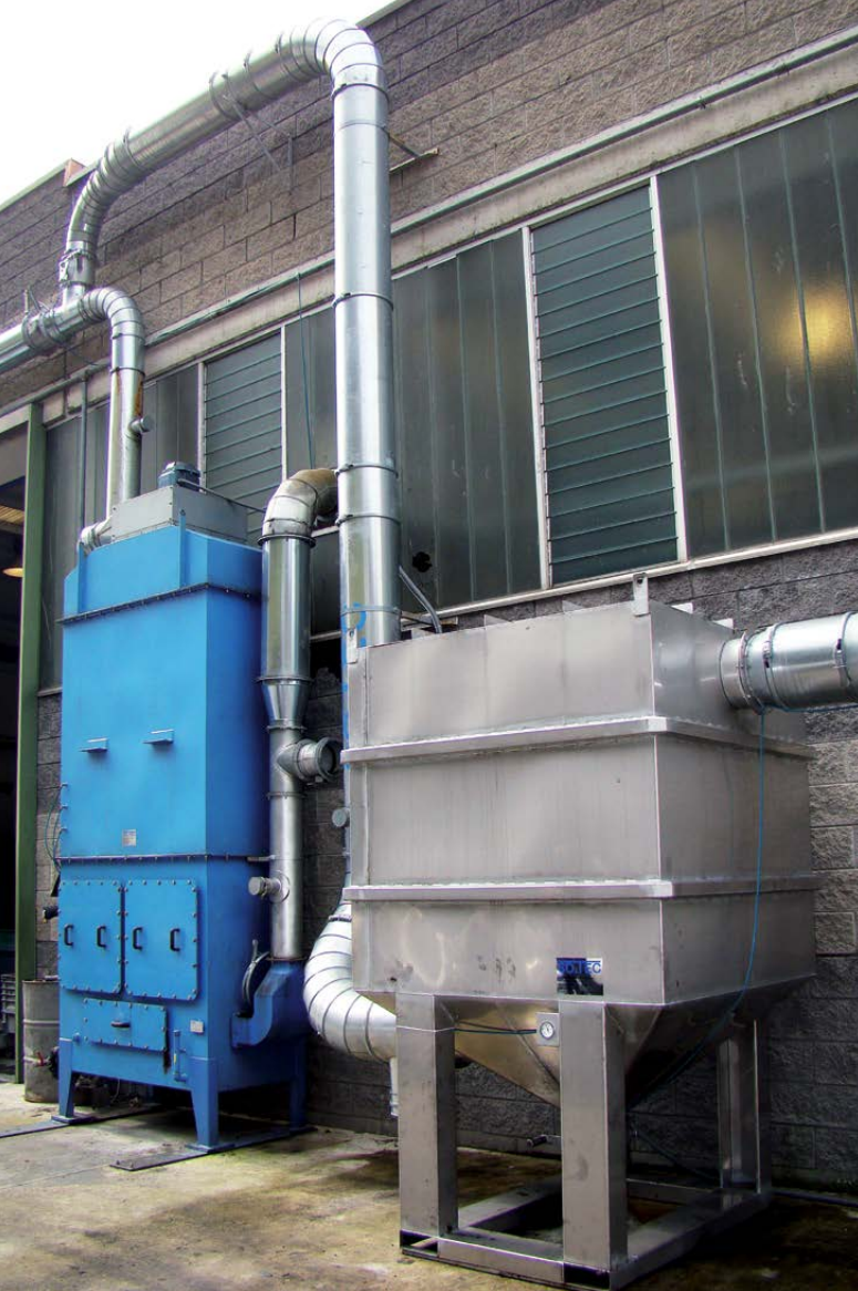
> Impianto pilota a coalescenza con carboni attivi per 2 forni a ciclo normale installato presso la ditta Gom-fer in via Campagnola
